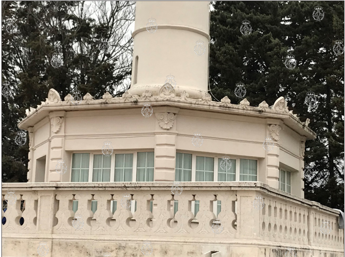
Aspecto actual de la base de la Torre de Señales, en la que se ha rebajado la altura de los dinteles de los huecos. Foto: P. Navascués.
