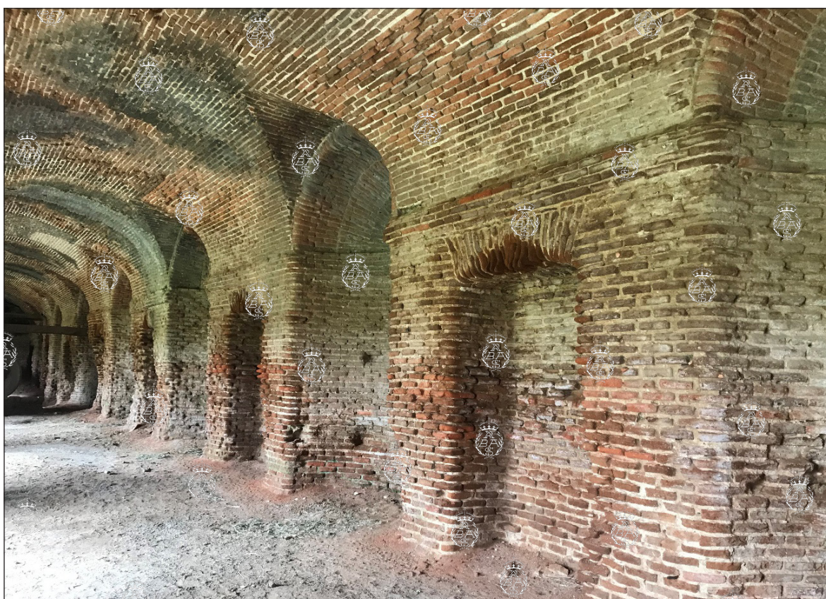
Arriba: Escalera que une el jardín alto con el nivel intermedio, en donde se encuentran las galerías porticadas, abajo, necesitado todo de una restauración. Foto: P. Navascués (abril, 2021).
