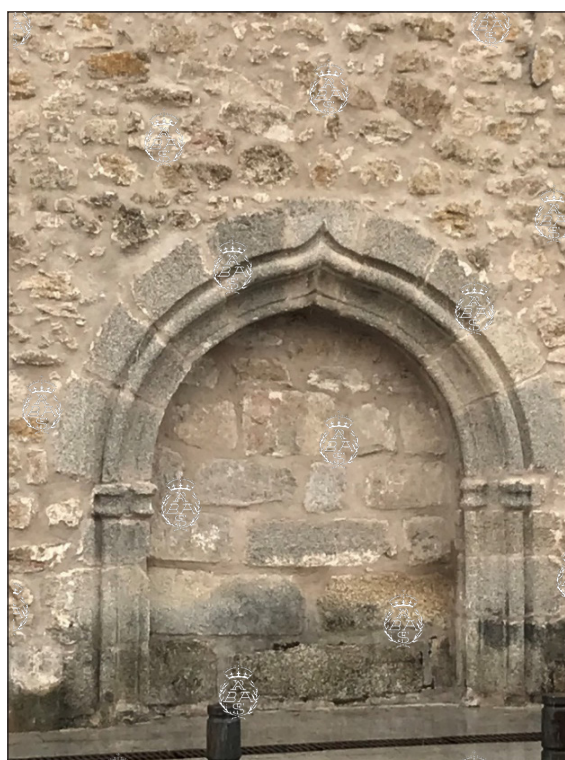
Puerta lateral del Evangelio, con acceso desde la calle y Plaza de Adolfo Suárez, cegada en una de sus múltiples "restauraciones" (1948, 1970, 1995 y 2012). En el Consejo Regional de Patrimonio, el presidente de esta Comisión de Monumentos sostuvo, sin éxito, su declaración como Bien de Interés Patrimonial, en lugar de BIC, propuesta que no prosperó, dando por buenas las intervenciones e invenciones que alteran sustancialmente su carácter, sin matiz alguno. Ello puede entenderse como estímulo para alterar el patrimonio cultural al margen de lo que la Ley señala. Foto: P. Navascués (6/7/2021).
