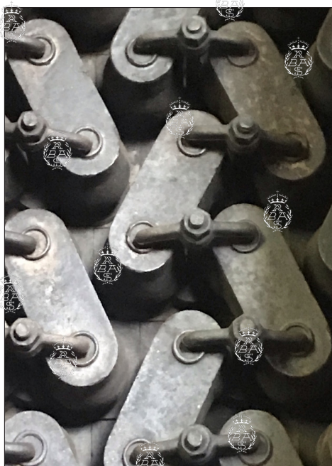
Detalle de las calderas, con el sistema de circulación del agua. Foto: P. Navascués.
