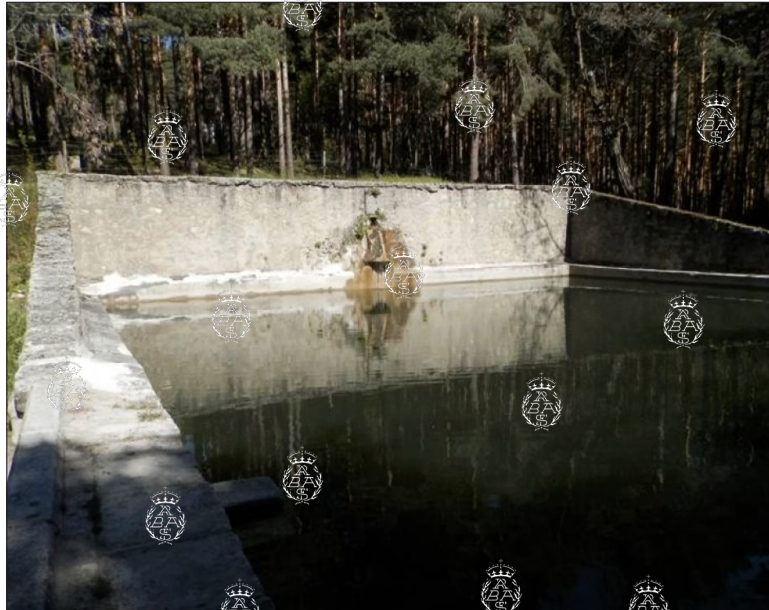
Estanque para la alimentación de la máquina de vapor y para extinción de incendios. Foto: autor desconocido.
