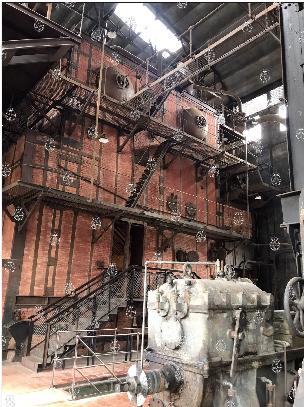
Caldera Walther con el nuevo acceso para ver su interior y la defensa de la bajada al cenicero, en la planta inferior de la nave de calderas, desde donde se conducía la escoria al río. Foto: P. Navascués.
