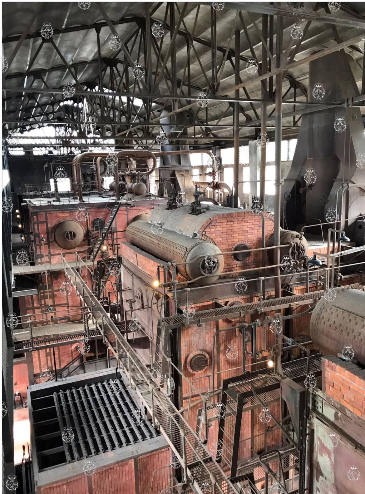
Vista general del interior de la nave de calderas. En primer término, las Babcock & Wilcox , de Bilbao, y al fondo las alemanas de la casa Walther . Foto: M. C. Utande.
