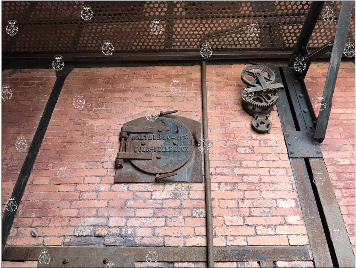
Detalle y registro de la caldera Walther . Foto: P. Navascués.
