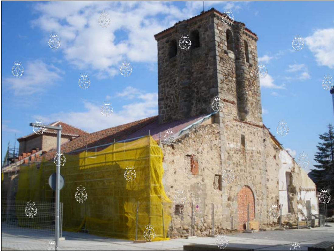
La parroquia de Bustarviejo durante las obras de restauración. Reproducido por E. Martínez Borrell en "Técnicas y sistemas de edificación", ETSAM (UPM) 2010, p. 53.
