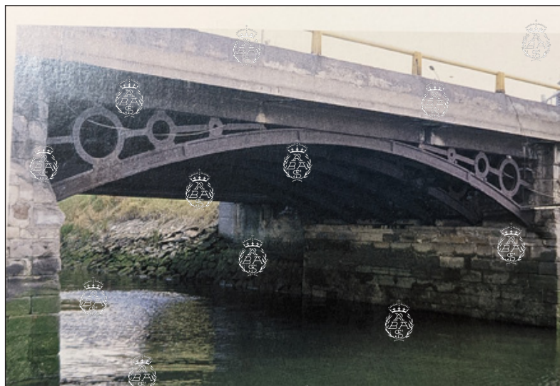
Puente de Udondo, en la desembocadura del río Udondo-Gobelas, en el municipio de Leioa, en Bilbao, cuyo arco metálico colocado en 1876 procede del antiguo puente de Isabel II. Arquitectura e ingeniería del hierro en España (1814-1936) , por Pedro Navascués Palacio (2007), p.157.
