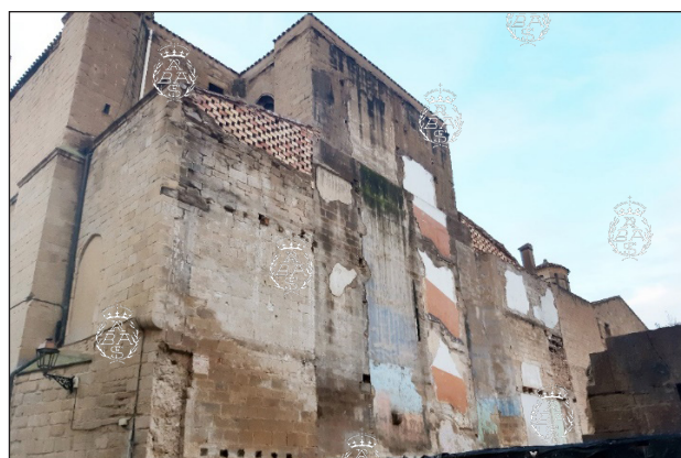
Testero de la iglesia Santa María Palacio en Logroño, tras el derribo del edificio adosado al este (foto: M. Sáenz, 15 diciembre de 2022).
