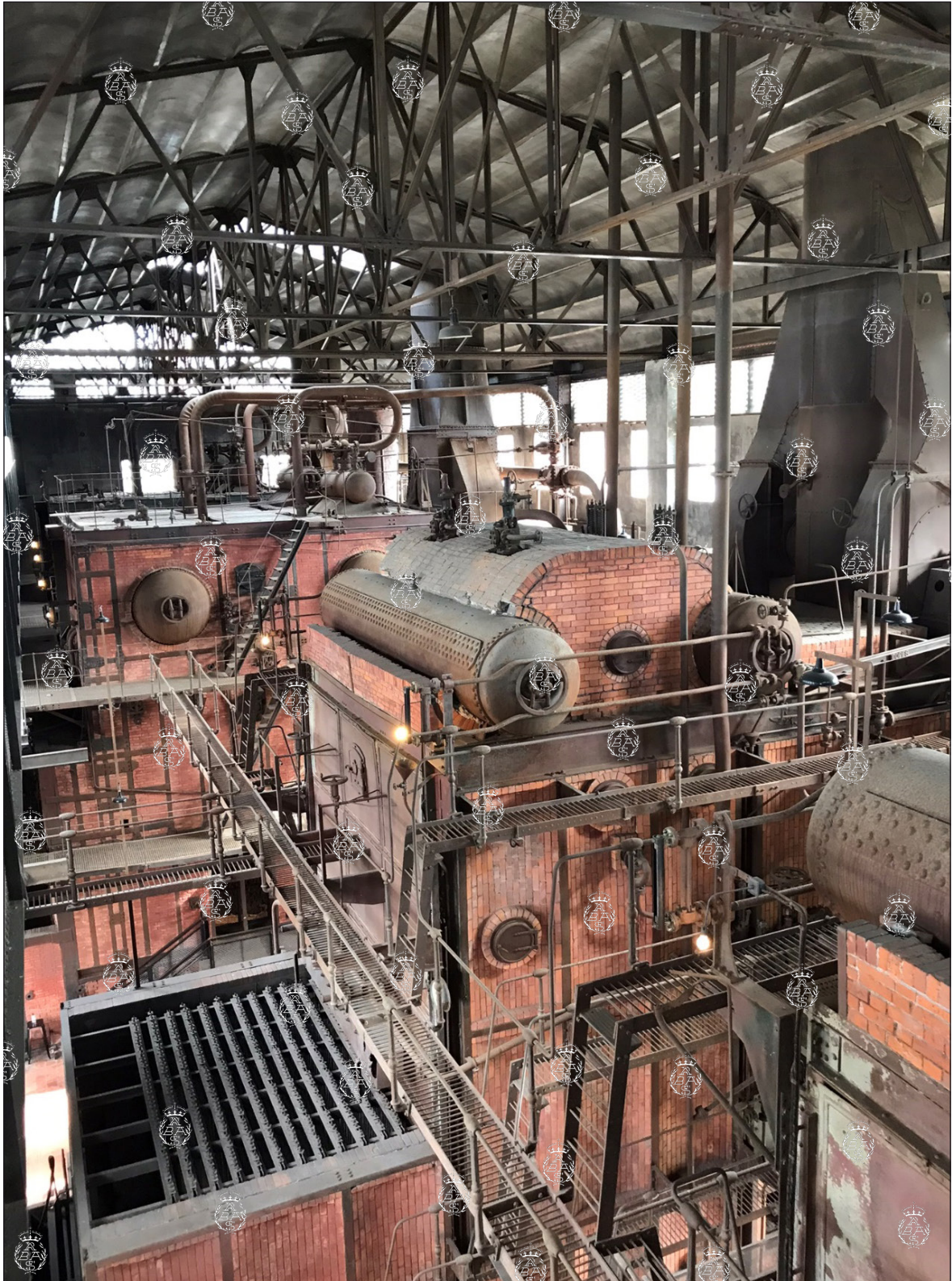
Vista general del interior de la nave de calderas. En primer término, las Babcock & Wilcox , de Bilbao, y al fondo las alemanas de la casa Walther . Foto: M. C. Utande.
