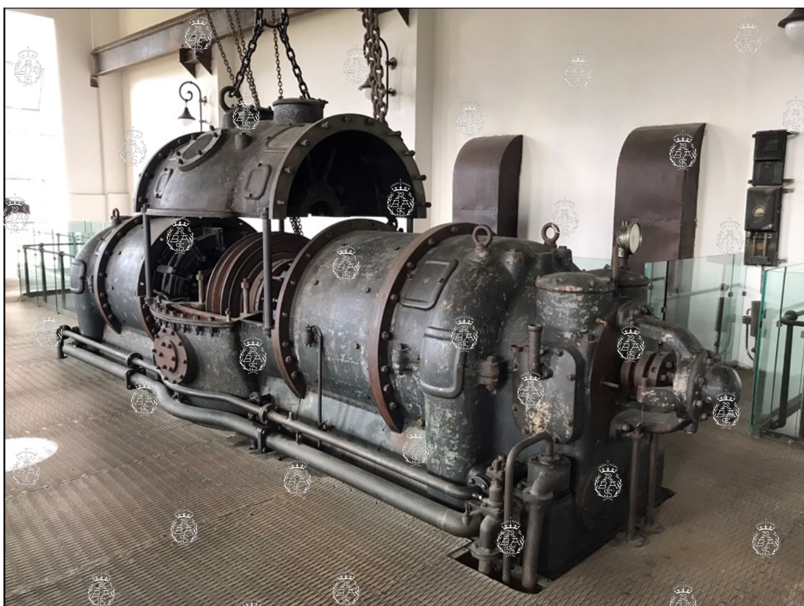
Sala de turbinas. Una de las dos turbinas de vapor, tipo Ljungström , construidas por ASEA ( Allmänna Svenska Elektriska Aktiebolaget ) (Compañía General Eléctrica Sueca) de 3 MW. Foto: M. C. Utande.
