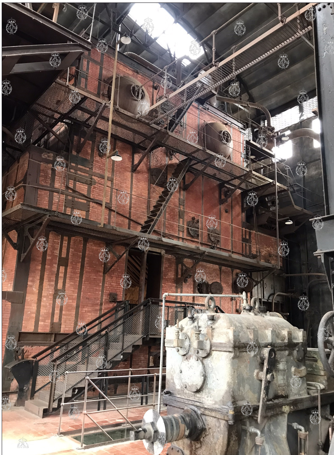
Caldera Walther con el nuevo acceso para ver su interior, al eliminar dos paños de ladrillo, y la defensa de la bajada al cenicero, en la planta inferior de la nave de calderas, desde donde se conducía la escoria al río. Foto: P. Navascués.
