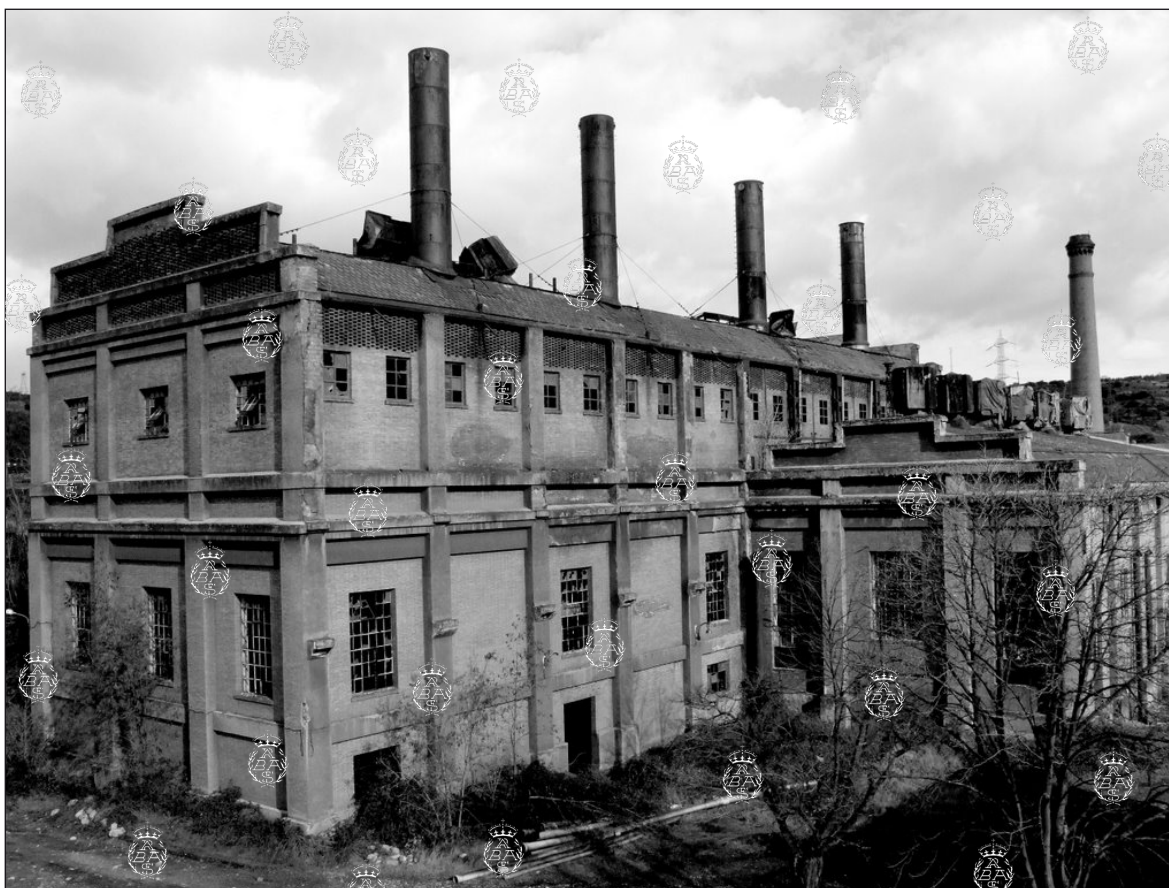
Nave de calderas y, a la derecha, nave de turbinas, antes de su rehabilitación y restauración. Foto de la Colección de la MSP.
