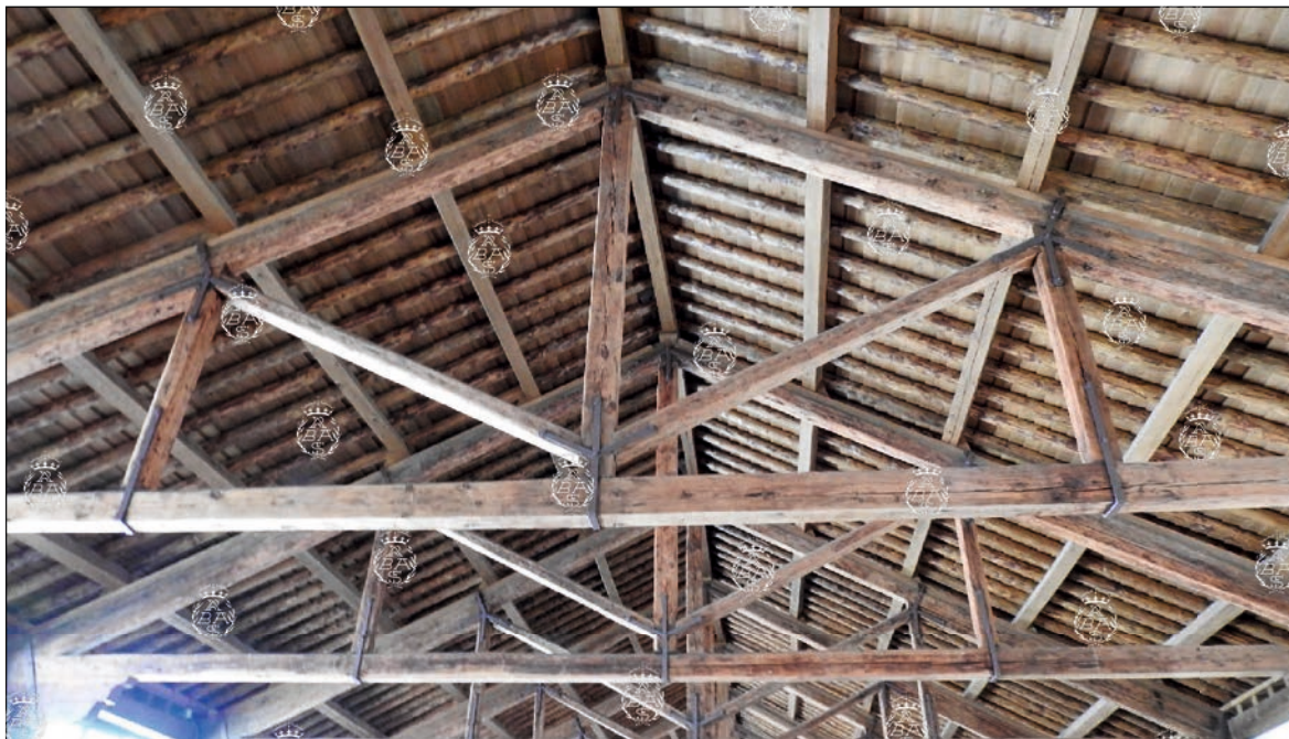
Detalle de la cubierta de cuchillos triangulados. Foto: C. Muñoz de Pablos.
