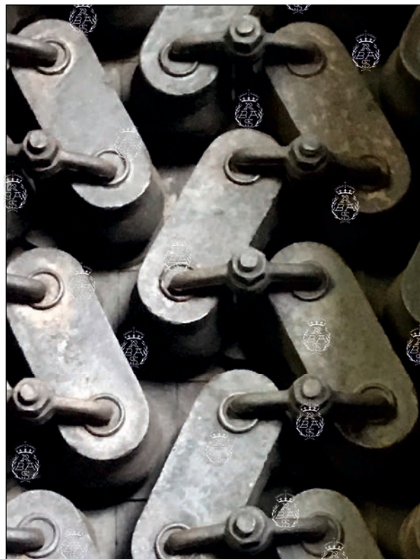
Detalle de las calderas, con el sistema de circulación del agua. Foto: P. Navascués.
