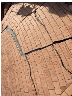
IMAGEN 5 GRANDES FISURAS EN LAS CAPAS DE RECUBRIMIENTO
