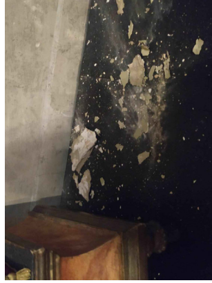
IMAGEN 6. DESPRENDIMIENTOS QUE AFECTAN AL PATRIMONIO MUEBLE DE LAS CAPILLAS Y EL CORO
