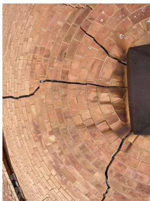
IMAGEN 4 GRANDES FISURAS EN LAS CAPAS DE RECUBRIMIENTO
